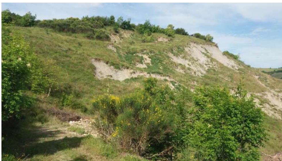
Foto 4 – dettaglio della foto precedente con ripresa lungo la vicinale i Monti. Sono ben visibili i colamenti argillosi superficiali lungo il versante (ex fronte cava) che ancora presenta le forme residuali delle gradonature di scavo.
